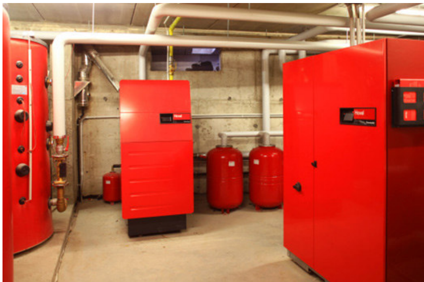
Figura 33: Dettaglio dell'impianto geotermico a servizio del complesso residenziale. Fonte: hoval.it
